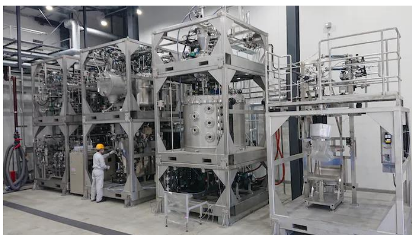
図1 高砂ケミカル掛川工場に構築された実証プラント
